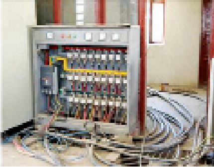
یک پنل توزیع برق 400 کیلوولت که در حال لین دوانی توسط آپریتر های افغان فابریکه تولید برق 1 شهر خوست است (عکس از SIGAR)
