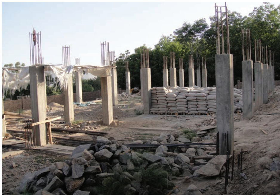
عدم تخریب ساختمان نیمه کاره در مکتب حبیب رحمان که سبب عوارض ایمنی و طرح ریزی جدی شده است. (عکس SIGAR)
