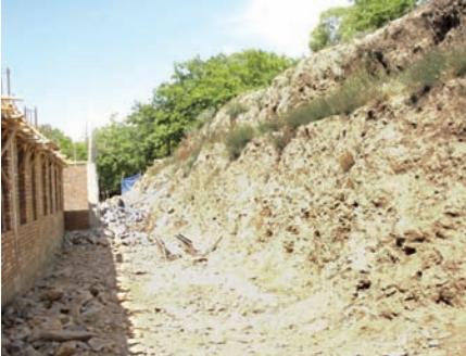
دیوار پشتمی مکتب حبیب رحمان که نشان دهنده نبودن دیوار یک دیوار نگهدارنده است و خطراتی را به سبب سقوط سنگ یا حرکت گل ایجاد می کند. (عکس تیم بازسازی ولایتی کاپیسا)
