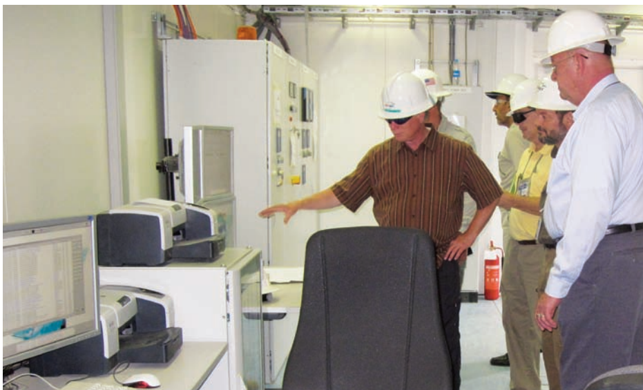
در حین تفتیش از نیروگاه کابل. کارمندان سرمفتش خاص برای بازسازی افغانستان. اداره انکشاف بین المللی ایالات متحده و کمپنی Black & Veatch اطاق کنترل را بازرسی می کنند. (عکس SIGAR)
