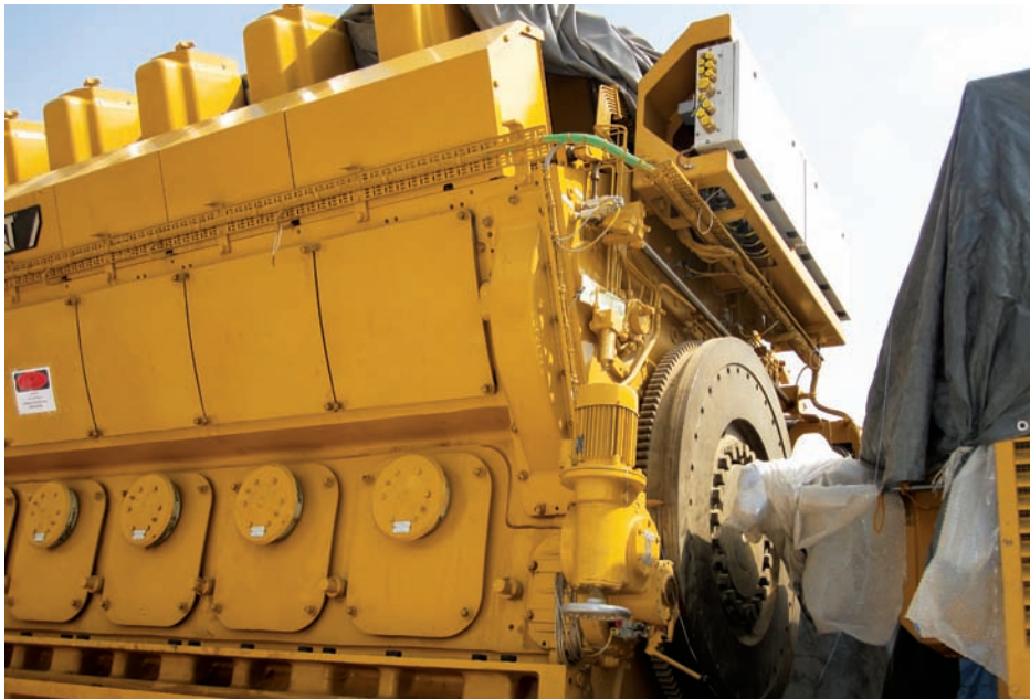
یکی از 18 جنراتور نیروگاه کابل. (عکس SIGAR)
