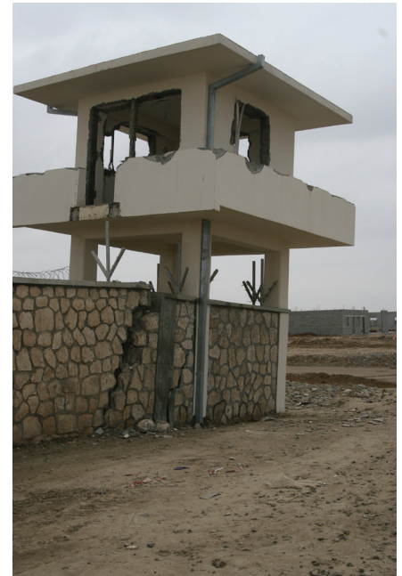
نشست شدید خاک سبب کج شدن محل استقرار نگهبانان و ترک خوردن دیوارهای اطراف آن گردیده است. سرمفتش خاص برای بازسازی افغانستان اخیراً مشکلات عمده ای را در ثبات خاک محل ساخت سربازخانه اردوی ملی افغانستان در کندوز مشخص نموده است. (عکس SIGAR)
