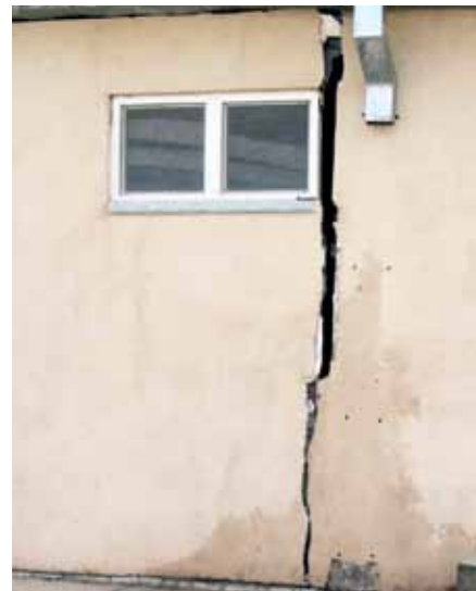
ناکامی در تثبیت درست خاک قبل از اعمار کمپ پامیر گارنیزون ANA در ولایت کندز به صدمه ساختاری جدی ناشی از نشست خاک منجر شد، مثل این ساختمان. (عکس سرفتمش خاص برای بازسازی افغانستان)
