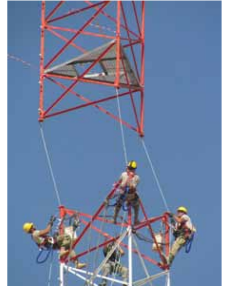
کارمندان نیروی هوایی در میدان هوایی بگرام اجزای یک برج ارتباطی 170 فتی را برای انکشاف محدوده ارتباطات رادیویی متصل می کنند. (عکس از نیروی هوایی)
