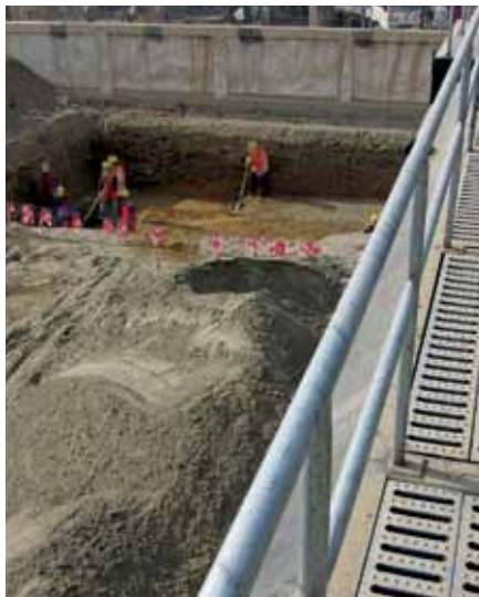
خاکبرداری بیش از حد از بسترهای تصفیه فاضلاب. (عکس سیگار)
