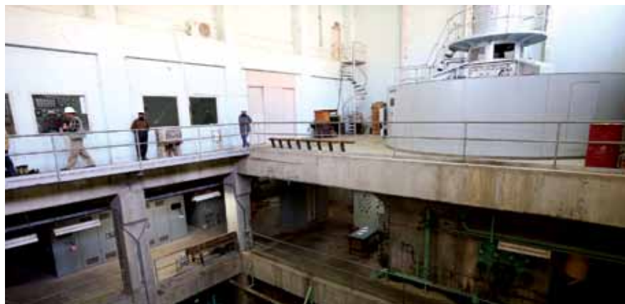
سالون توربین فابریکه برق آبی کجکی در ولایت هلمند در حال حاضر دو توربین مثل توربین نشان داده شده در طرف چپ دارد. توربین سوم که در سال 2008 حمل شده با مساعدت ایالات متحده نصب خواهد شد. (عکس از وزارت امورخارجہ ایالات متحده)
