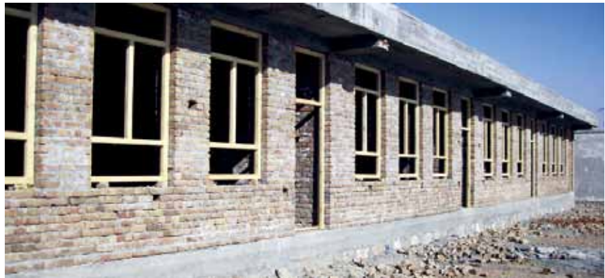
مکتب ای در ولایت بتخاک که قراردادی آن را با پنجره های چوبی و دیوارهای آجری، به جای پنجره های بادوام وینیلی و بلوک های سیمانی، ساخته است. (عکس SIGAR)
