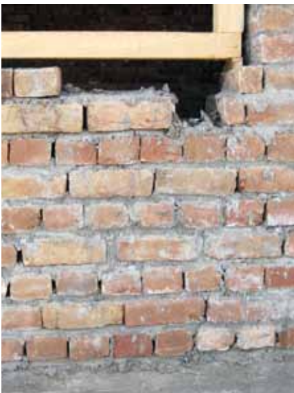
نواقص ساختمانی مشاهده شده در مکتب بتخاک شامل شکاف های عظیم بین خشت ها در دیوار نگه دارنده سقف و بام می باشند. (عکس SIGAR)
