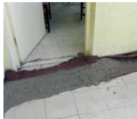
محاسبین سرمفتش خاص بازسازی افغانستان متوجه شدند که شیب سقف طبقه دوم به سمت درواز صنف درسی بوده و برای جلوگیری از ورود آب باران به صنف نیاز به ایجاد مانع دارد. (عکس سرمفتش خاص بازسازی افغانستان توسط لس تامپسون)
