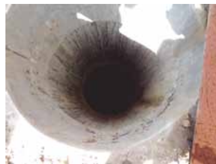
نقطه دسترسی به تانک سپتیک دارای پوشش چدنی محکم یا زینه دائم نیست، در حالی که هر دو این موارد بر اساس قرارداد الزامی بوده است. (عکس سرمفتش خاص بازسازی افغانستان توسط تن-کیت)
