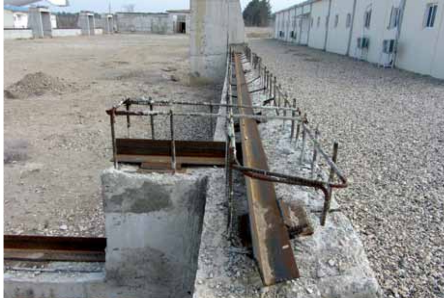
طی تفتیش SIGAR از کمپ مانیتور مشخص گردید که اعمار غذاخوری محدود به پایه های کنکریتی با کیفیت نامناسب و سطوح ناهموار و ترک خورده کنکریتی است. (عکس از SIGAR)
