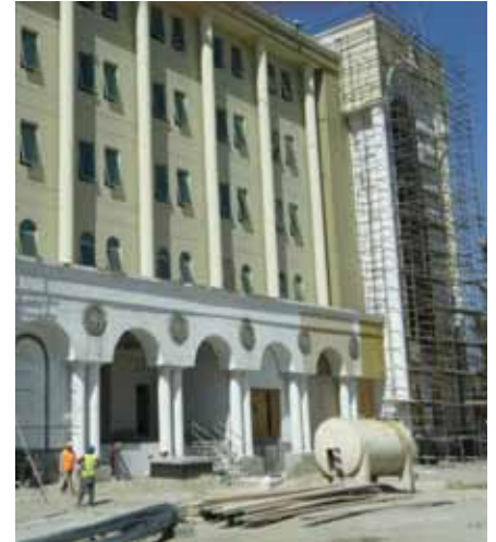
ساختمان قرارگاه مرکزی وزارت دفاع در حال اعمار در کابل، سپتمبر 2014. (عکس CSTC-A)
