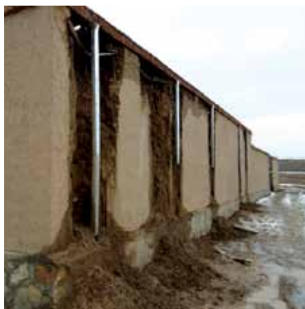
مواد و روش های ساختمانی نادرست و نیز ضعف برنامه ریزی و نظارت، باعث نفوذ آب و تخریب خارجی پولیگون خشک و ضروری شدن بازسازی آن شده است. (عکس NPTC)
