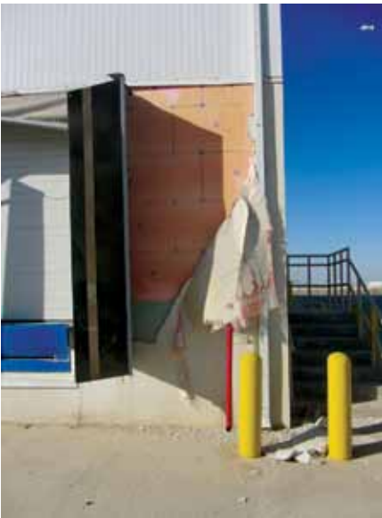
نظارت سیگار از یک گدام در KAF نشان میدهد که تعدادی از نواقص کوچک در کار ساختمانی وجود دارد بشمول خرابی ها در رنگ قسمت خارجی ساختمان. (SIGAR عکس توسط رونالد شنايدر)
