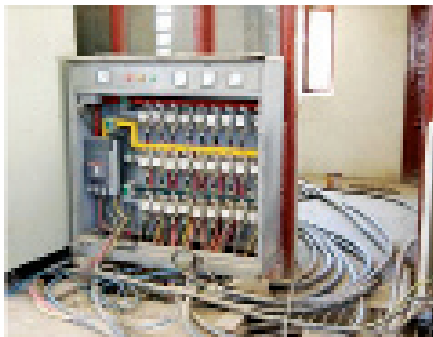
یو د ۴۰۰ کی وی برېښنا رسوونکی پینل چې د خوست په برېښنايي پلانټ ۱ کې د افغان پلانټ چلونکیو لخوا بیا تړل شوی. (د سیگار انځور)
