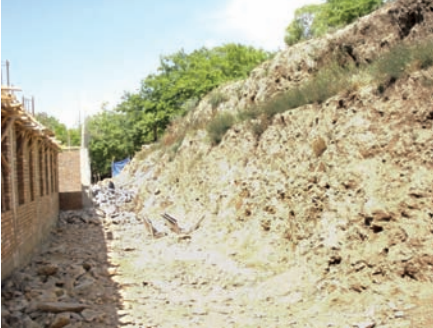
د حبیب رحمن ښوونځي د شا ديوال د شا د ملاتړ ديوال نشتوالی ښيي، چې د ډبرو او ځمکي د ښویدلو د احتمالي خطر سبب کېږي. (انځور د کاپيسا د ولايتي بيا رغونې ټيم)
