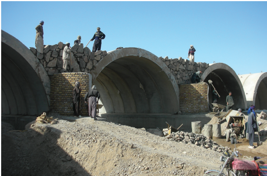
افغان ساختماني کارکوونکي هغه ټولونه د یو بل سره پیاوړي کوي چې د فراه په سیند د توح پول د ملاتړ لپاره اچول کېږي. سیکار د دې پروژې د څنډېدنې په تړاو د سمبالټ، نظارت او د معیار د کنټرول موندنې سند کړي دي. (د سیکار انځور)
