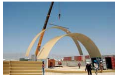
کارگران په بگرام هوایي ډگر کې د یو K-span په جوړولو بوخت دي. (د متحده ایالاتو د پوځ انځور)
