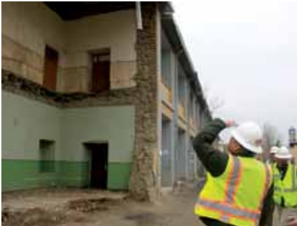
د مارچ 2014 پرمهال په افغانستان کې، خانګري پلټونکي یا مفتش د افغان دفاع وزارت قوماندانیو د ودانۍ څخه لیدنه وکړه، کومه چې دا مهال د جیرونې لاندې ده. (د سیکار تصویر د سمیت انډرسن لخوا)
