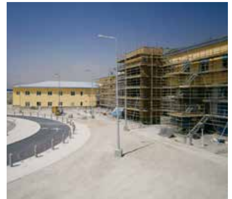
د 2014 په سپتمبر کې، په کابل کې د کورنیو چارو وزارت قرارګاه تر ساختماني کارونو لاندې ده. (د USACE تصویر)
