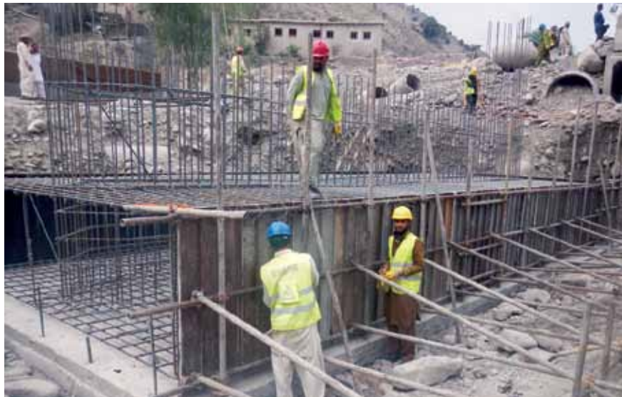
کارگران د یوه پل لپاره سټي جوړوي چې د ګردیز - خوست سرک بيارغولو پروژې برخه ده. (د USAID عکس)
